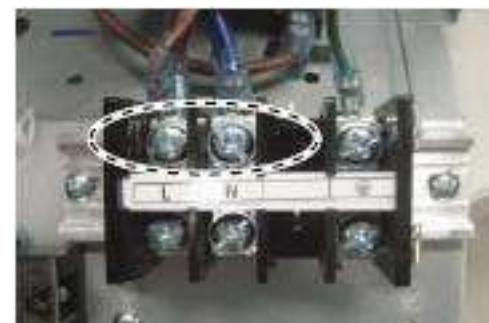
Contrôle alimentation électrique
