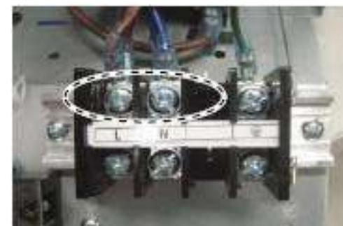
Contrôle alimentation électrique
